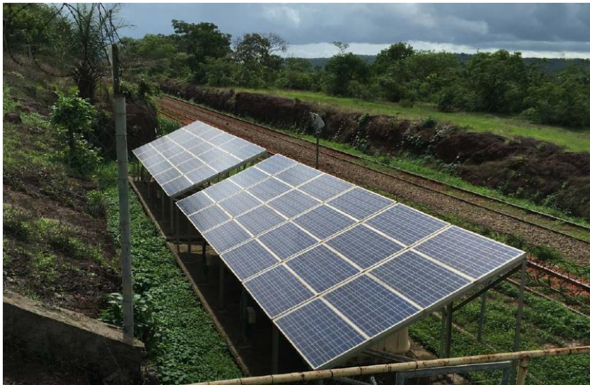
PV en bordure de voie ferrée
